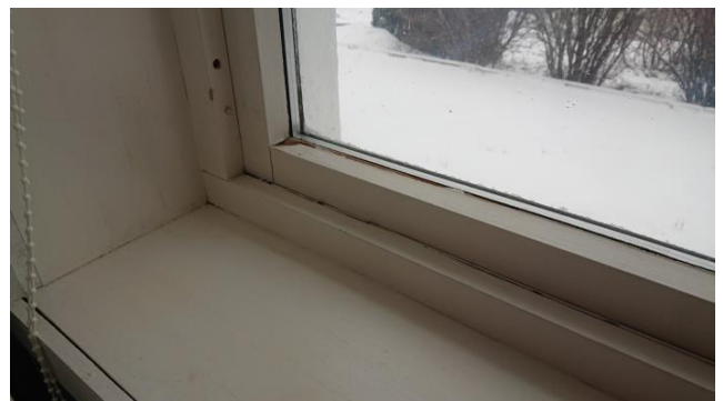
Flere vinduer har kondensskader i nedre kant av rammer.
