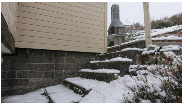
Håndlist eller rekkverk bør monteres.
