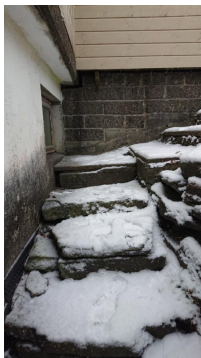
Håndlist eller rekkverk bør monteres.
