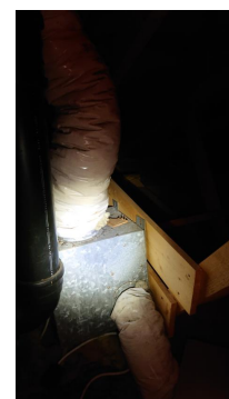
Mekanisk ventilasjon med aggregat på kaldtloft.
